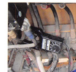
■電流計(クランプ) オーガ負荷電流を計測します。
